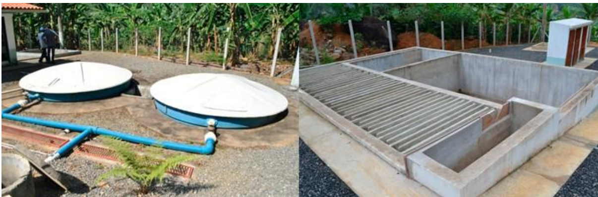
Figura 30 – Reservatórios ETA Sagrada Família (Reservatórios 20 m 3 )
